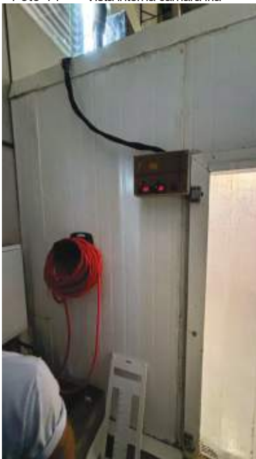
Foto 15 - Controle de comando externo
