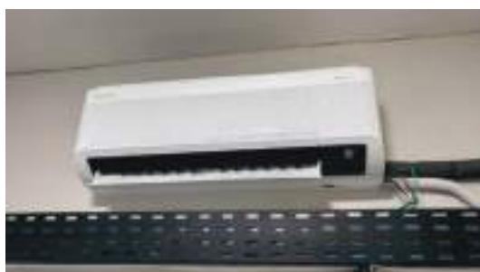
Foto 10 - Ar condicionado sala ADM
