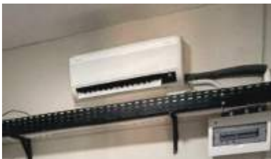
Foto 11 - Ar condicionado sala ADM
