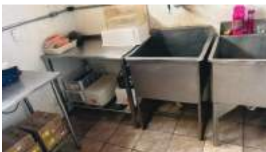
Foto 28 - Tanque para apoio de limpeza
