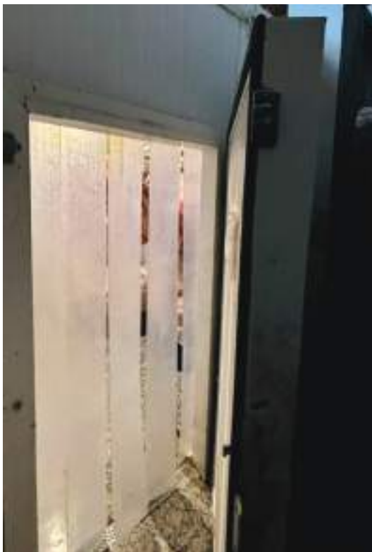
Foto 14 - Vista interna câmara fria
